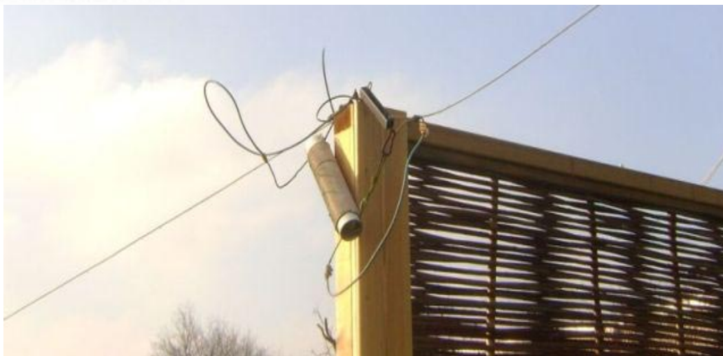
Bengelende verlengspoel aan mijn schutting
